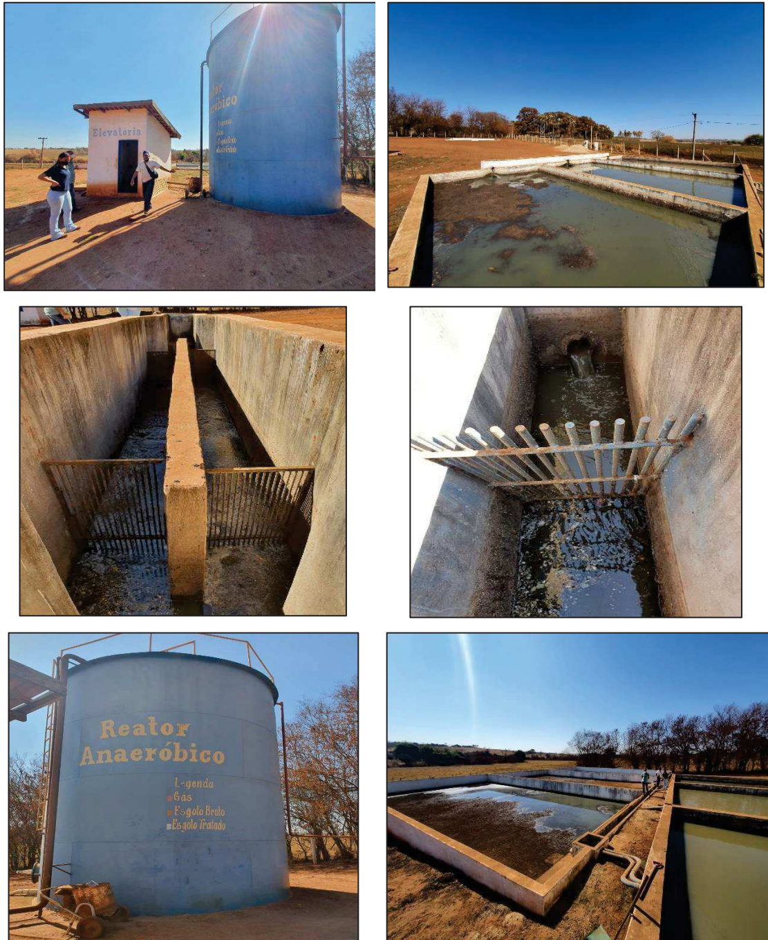
Figura 25 - Estação de Tratamento de Esgoto de Veríssimo.
