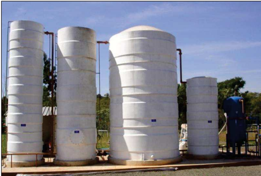
Figura 29 – Estação Compacta de Tratamento de Esgotos Sanitários.
